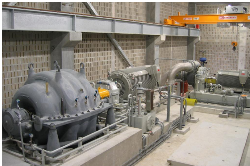
Figura 4: Instalação utilizando dois sopradores centrífugos de simples e múltiplos estágios.
